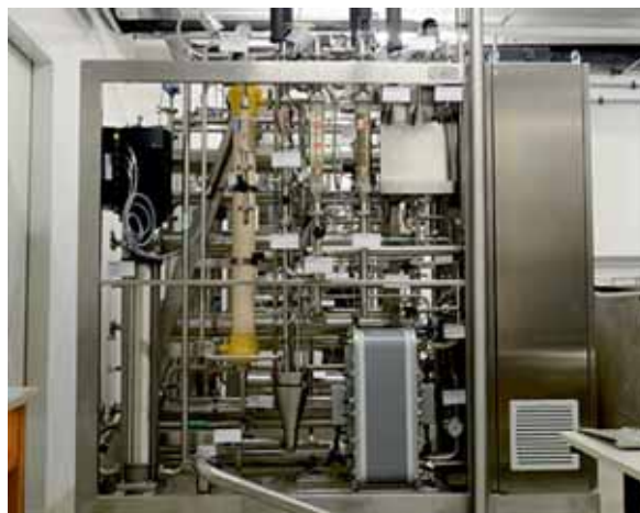
Abb. 3: Seitenansicht des Membransystems (Umkehrosmose-Anlage).
