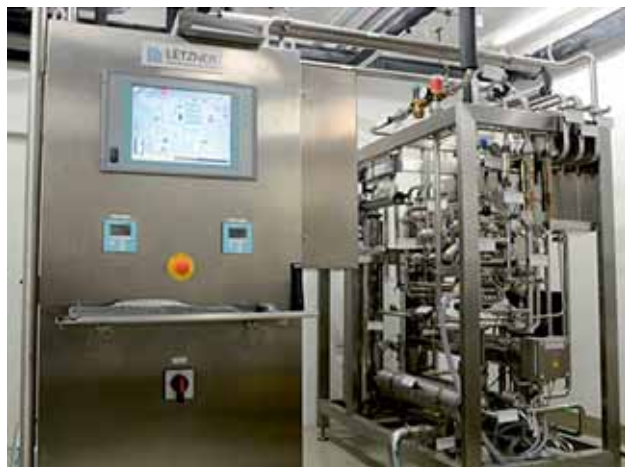
Abb. 2: Vorbehandlung rechts, Membransystem (Umkehrosmose-Anlage) links.
