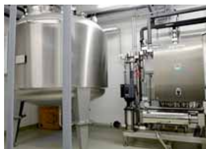
Abb. 4: Behälter und Rahmengestell mit Ringleitungskomponenten.
