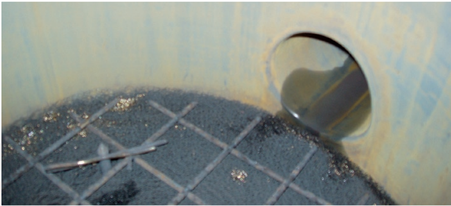
Abb. 1: Verunreinigung durch Rouging
