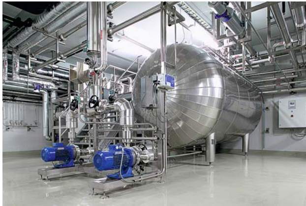
WFI-Tank der Firma Wiedenbauer Apparatebau, 15 000 Liter Fassungsvermögen.
