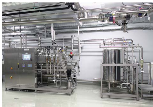
HPW-Anlage der Firma Letzner GmbH.
